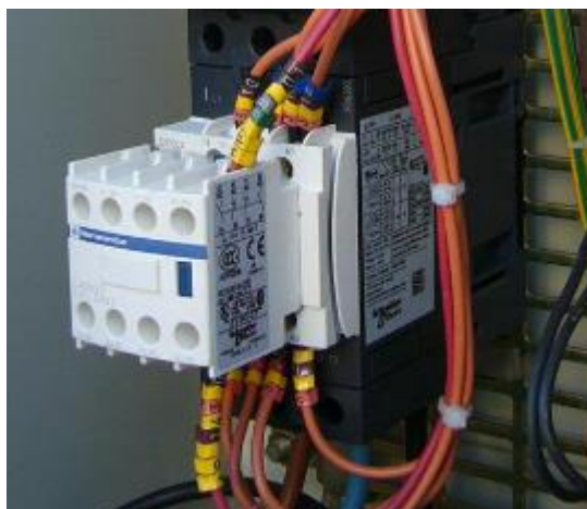
Рисунок 2.3 - Магнітний пускач для запуску електропривода
