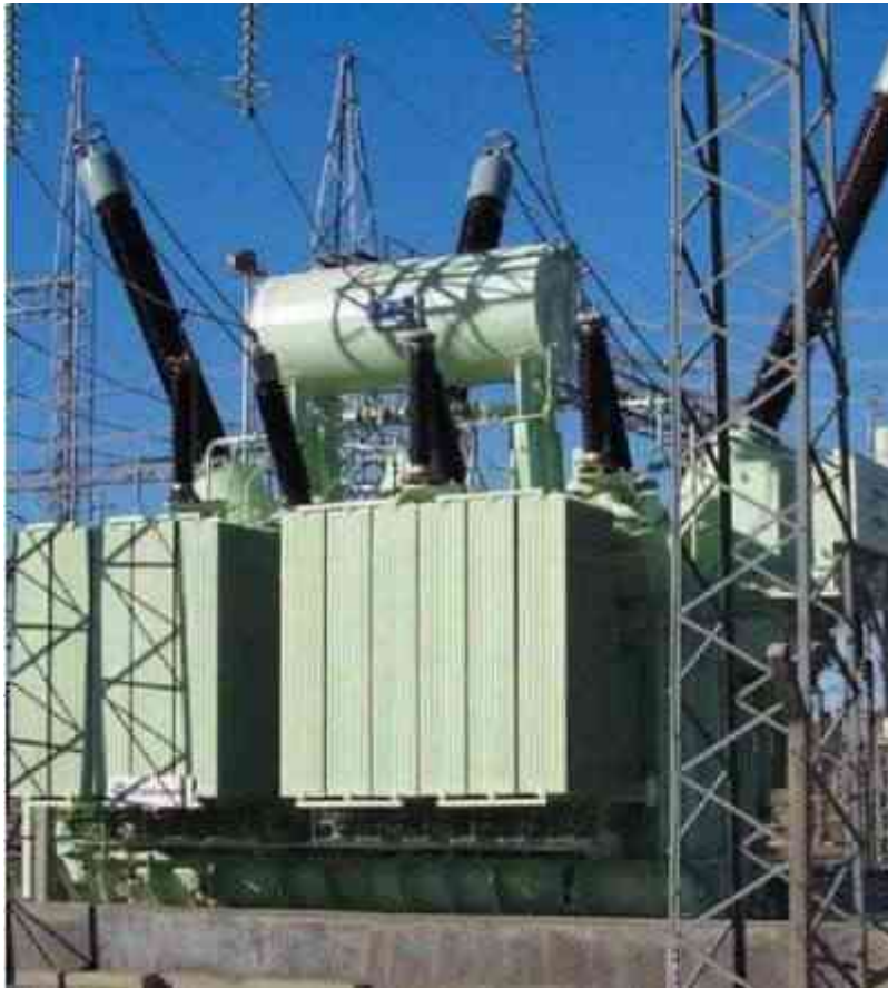
Рисунок 5 – Автотрансформатор АТДТН5150000/500/138 (виробник ПрАТ «Запоріжтрансформатор»)
