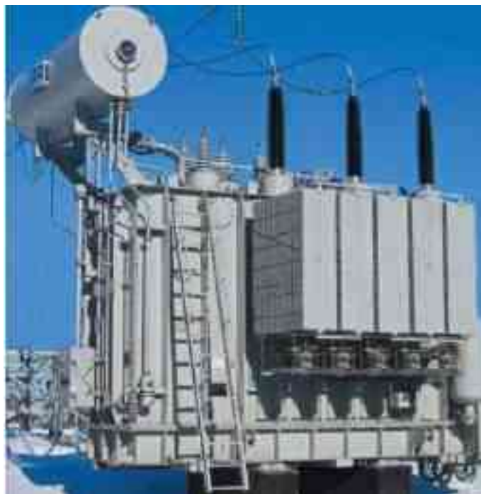
Рисунок 3.1 – Силовий трансформатор ТДТН563000/110 (виробник ПрАТ «Запоріжтрансформатор»)
