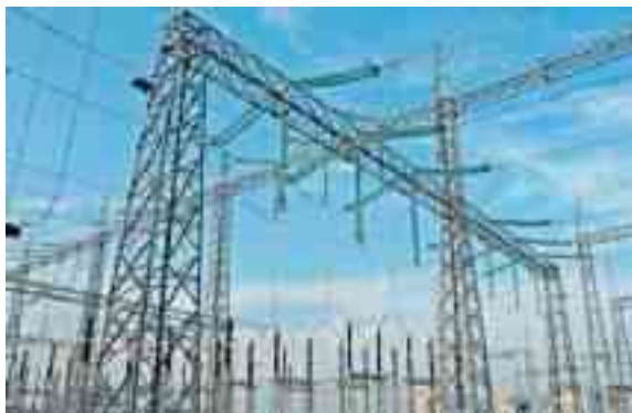
Рисунок 12.1 – Ділянка ВРУ 500 кВ з гнучкою ошиновкою
