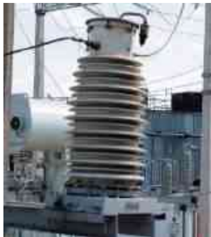
Рисунок 7.1 – Загальний вигляд трансформатора струму
