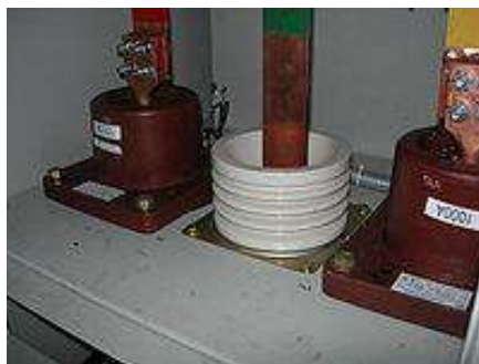
Два трансформатора струму в комірці КРУ — 10кВ
