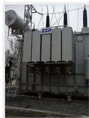
Силовий трансформатор потужністю 63МВА
