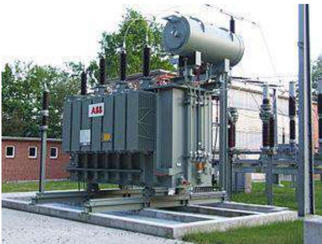
Трифазний силовий трансформатор трансформаторної підстанції відкритого типу
