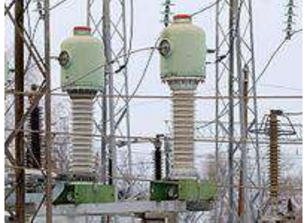
Елегазові трансформатори струму ТГФМ-110
