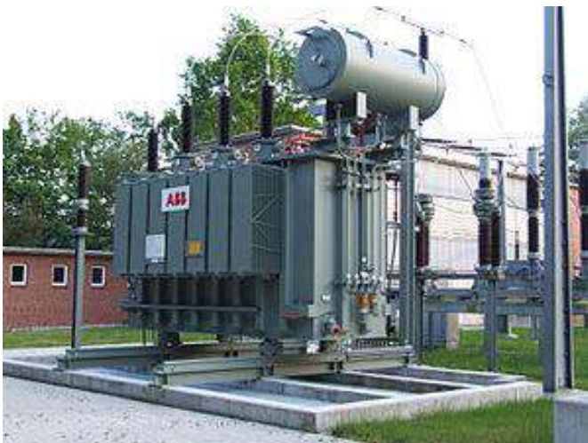
Трифазний силовий трансформатор трансформаторної підстанції відкритого типу
