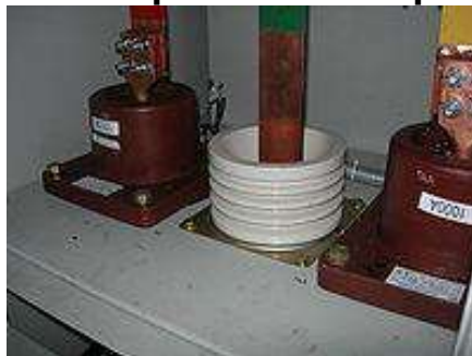
Два трансформатора струму в комірці КРУ — 10кВ
