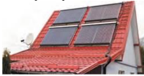
Рисунок 1.2. Сонячне тепло нагріває воду в спеціальних трубках. Будинок забезпечений теплою водою
