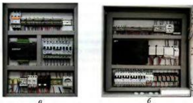
Рис. 14. Загальний вид щитів управління системою вентиляції і кондиціонування повітря
