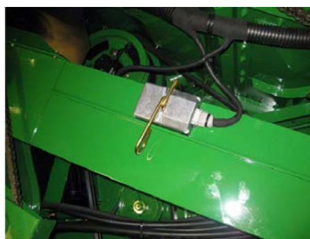
Рис. 4. Лазерний датчик на корпусі елеватора.
